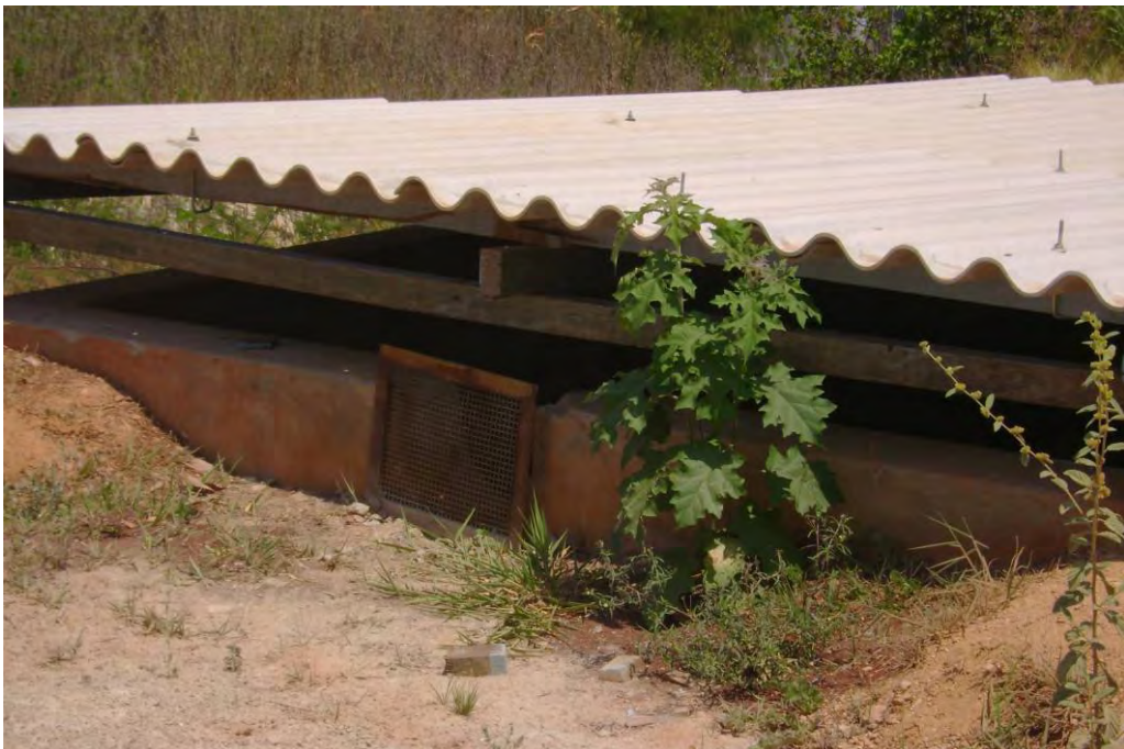
Figura 3.25 - Caixa coletora da drenagem superficial em operação (notar entrada da caixa).
