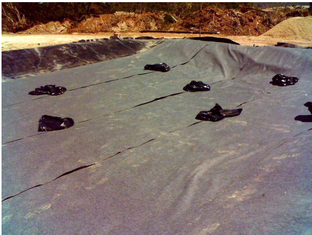
Figura 3.15 - Lançamento do geotêxtil sobre a camada de brita 1 (observar ancoragem do geotêxtil e traspasse entre os materiais).
