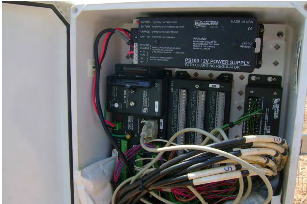
Figura 3.37 - Caixa de controle onde são realizadas as leituras dos TDRs.
