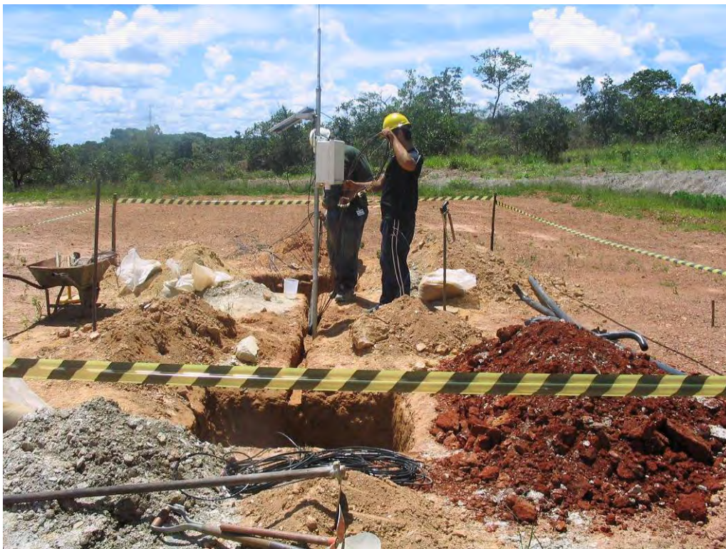
Figura 3.36 - Instalação da caixa de controle e painel solar.
