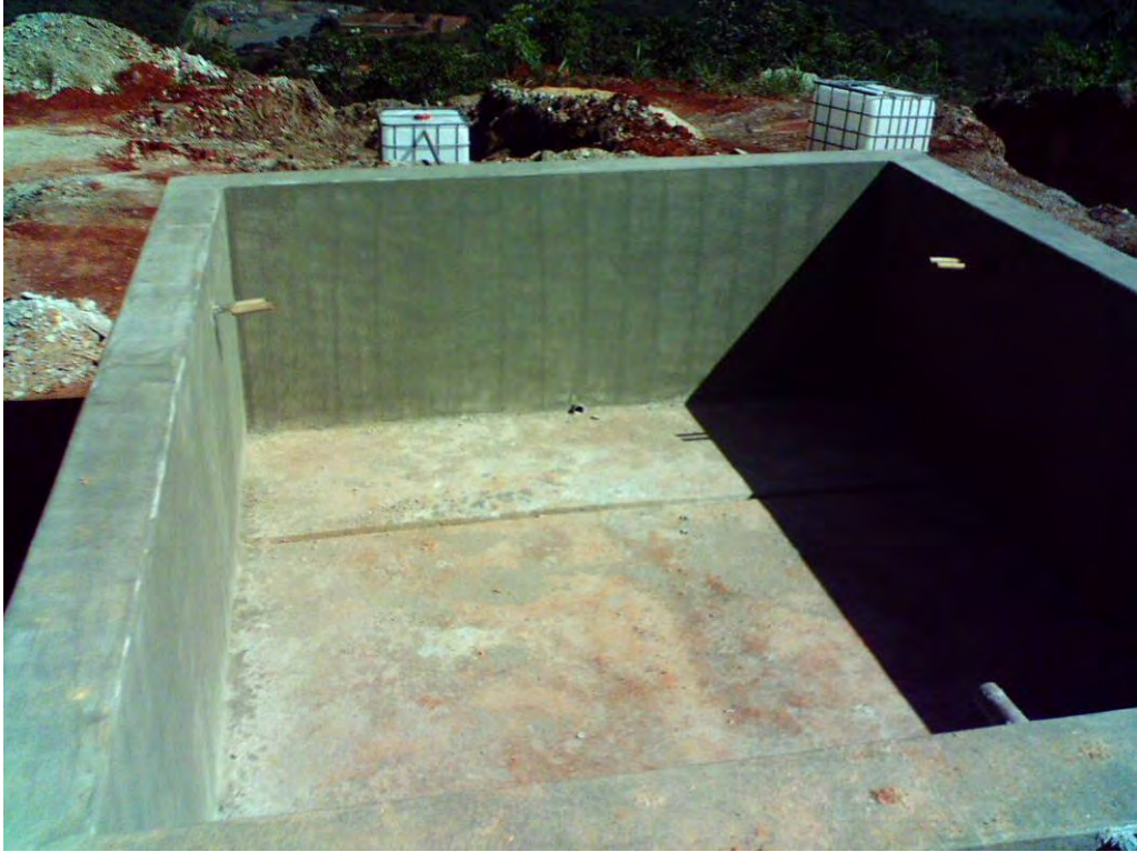
Figura 3.24 - Caixa coletora de água/contenção de sedimentos sem cobertura.
