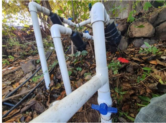
Figura 10: Tubulação do sistema de irrigação
