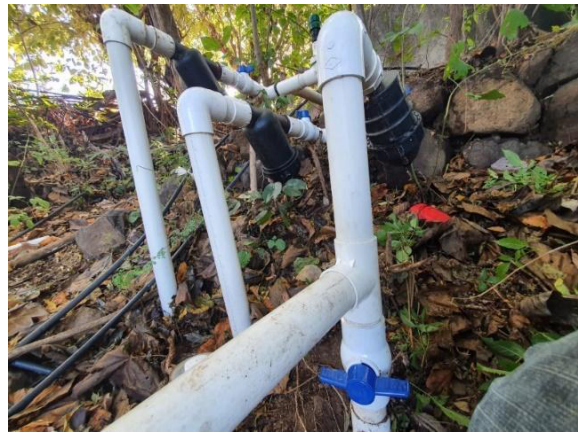
Figura 10: Tubería del sistema de riego
