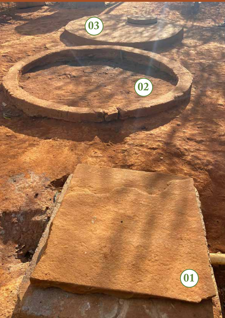
Figura 2. Sistema Bioágua Familiar instalado no agroecossistema da Família Gama (1 – Caixa de gordura; 2 – Filtro biológico; 3 – Tanque de armazenamento.).
