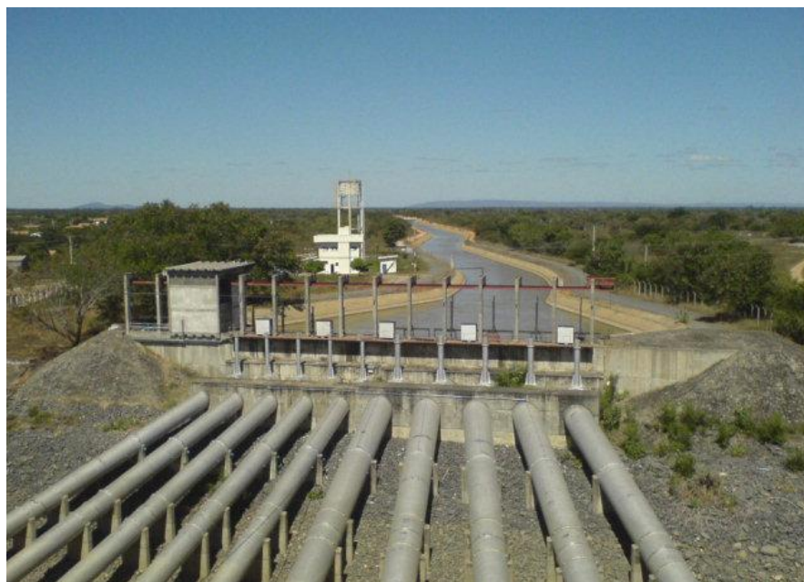
Figura 2.1 – Estação de bombeamento 1.
